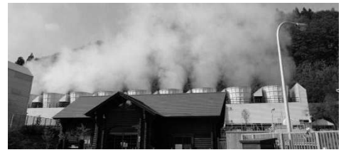
図1 地熱発電所の冷却塔
